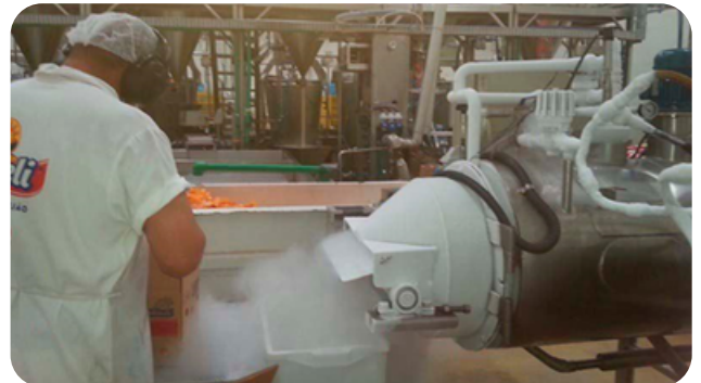
Figura 3.19. Tanque de congelamento criogênico
